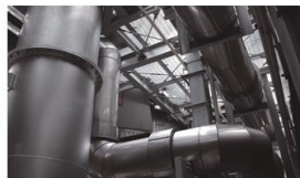
プラント配管
